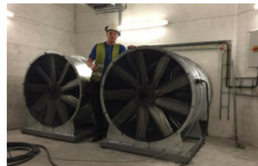
Stasjonsvifter Mauranger kraftverk
